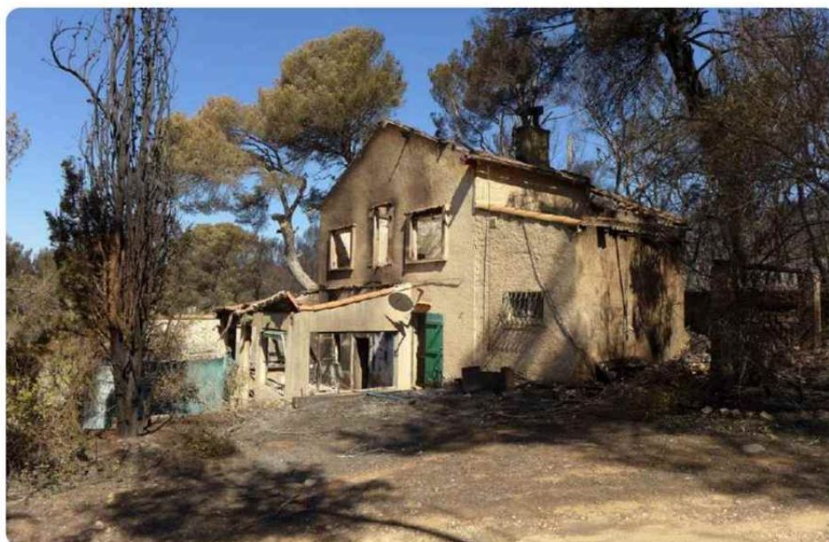
Maison non débroussaillée, partiellement détruite par le passage d'un feu, Rognac (13), source : ONF.
