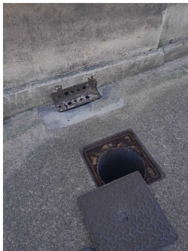
Vue extérieure du branchement
